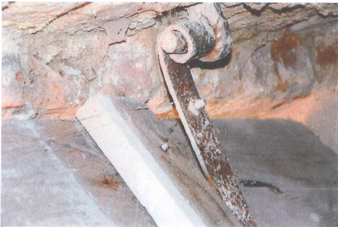
Krosno - kamienica przy ul. Portiusa 4 – piwnice – dawny areszt śledczy PUBP stan zachowania zachowania zawiasów przed konserwacją
