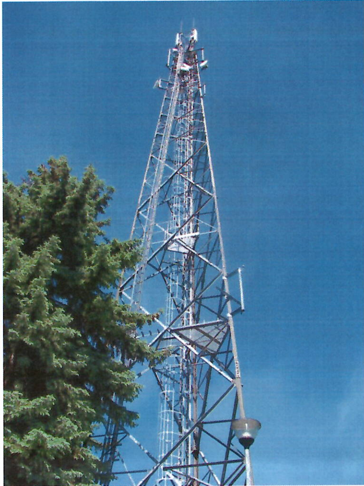
Zał. nr 1: Widok ogólny instalacji radiokomunikacyjnej.
