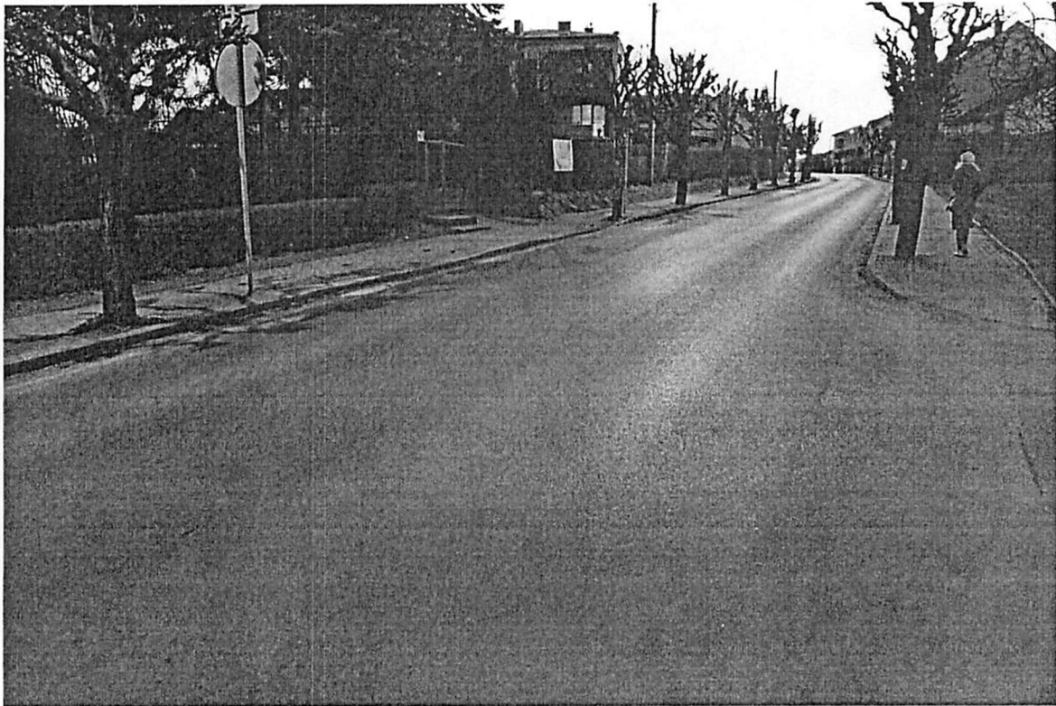
Fot. 1. Stan nawierzchni.
