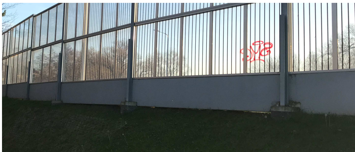
Rysunek 5.9.2. Przykład nieszczelności przy belce podwalinowej
