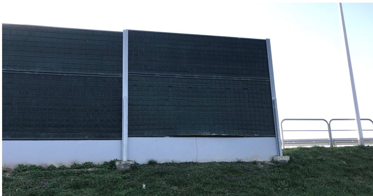
Rysunek 5.9.3. Uszkodzony ekran w rejonie ulicy Pochyłej
