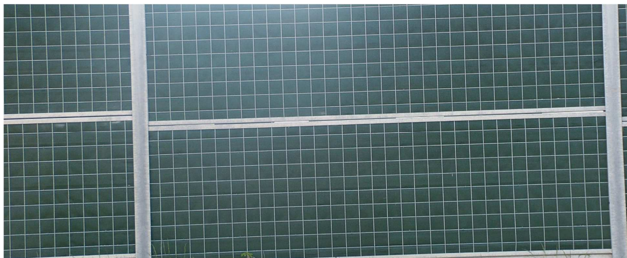
Rysunek 5.9.1. Przykład nieszczelności pomiędzy panelami
