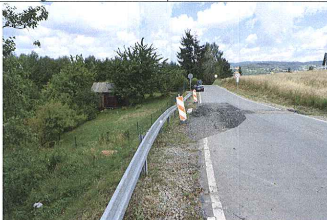
Widok na uszkodzoną drogę i fragment górnej części osuwiska
