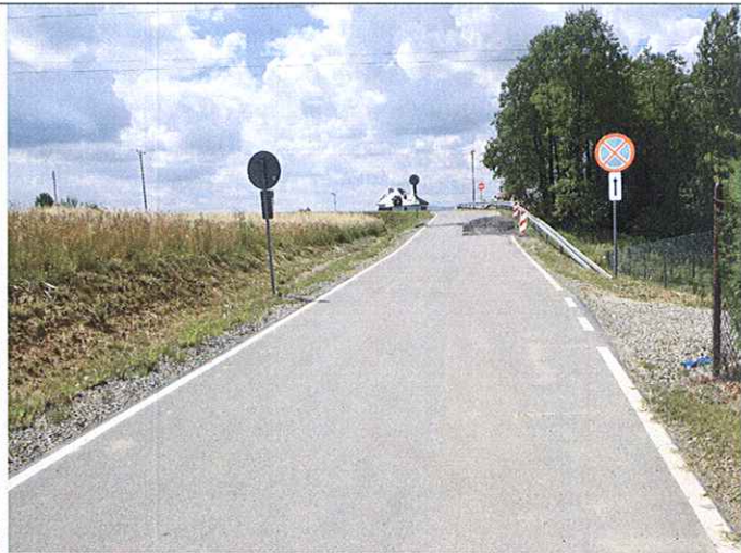
Widok na uszkodzoną drogę od północy
