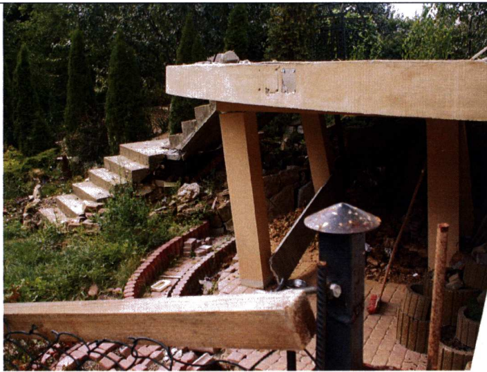
Uszkodzony taras domu 55
