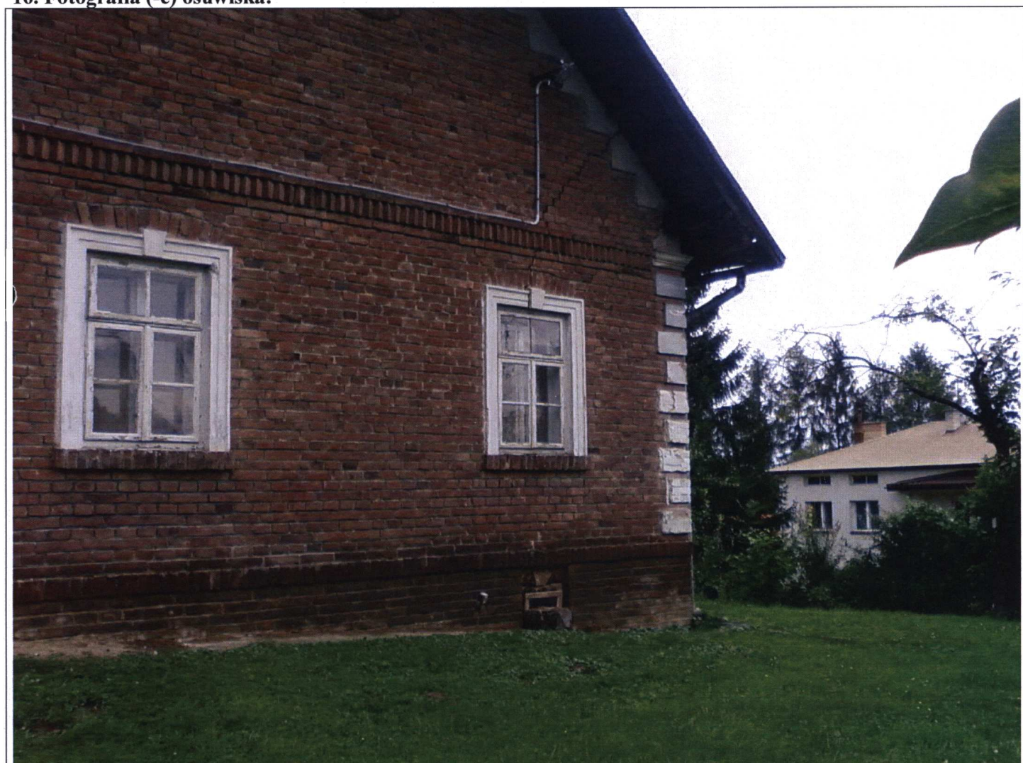
Spękany dom powyżej skarpy głównej
