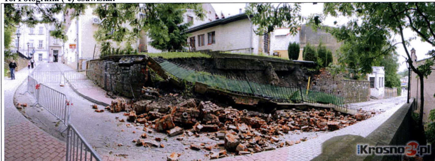
Zawalony mur na ul. Zjazdowej (źródło: http://www.krosno24.pl/informacje.php3?id=4085 )
