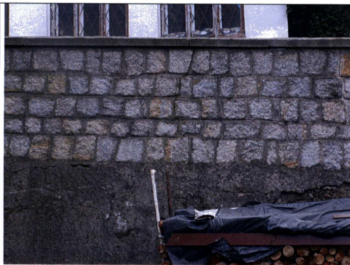
Spękania na murze oporowym poniżej ul. Zjazdowej
