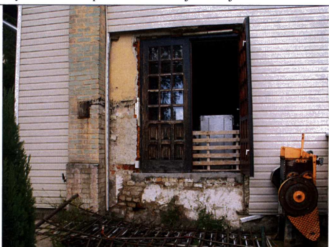
Uszkodzenia budynku powyżej ul. Zjazdowej
