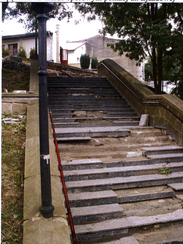
Zniszczone schody pomiędzy ulicami Zjazdową i Podwale
